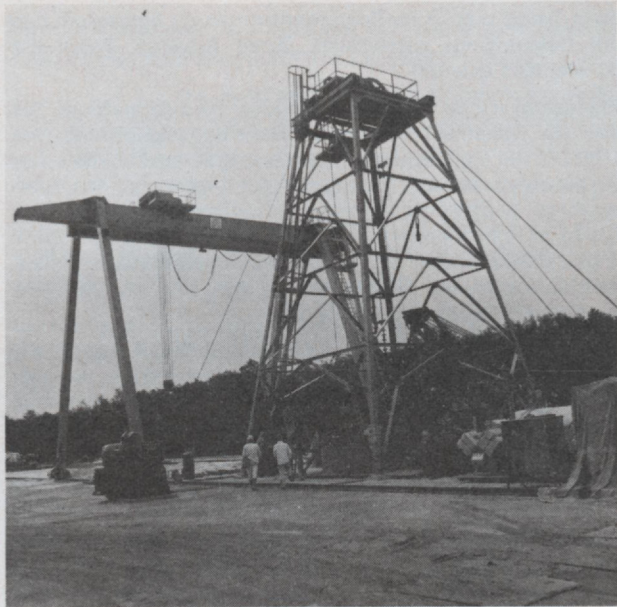
Notfahreinrichtung zur Befahrung des Bohrloches
