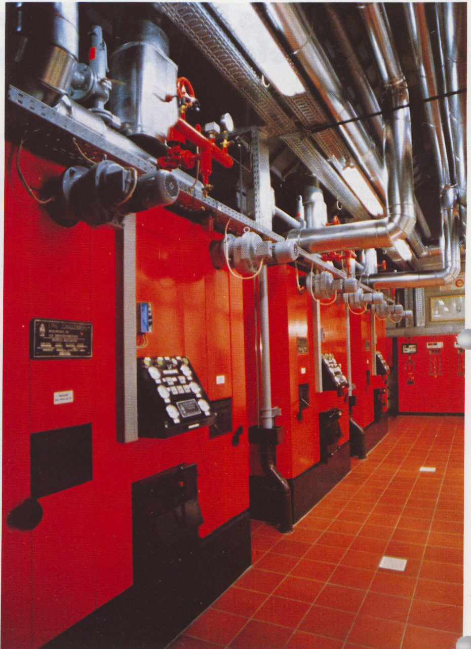
Die neue anthrazitbefeuerte Heizungsanlage im Krankenhaus Linnich
