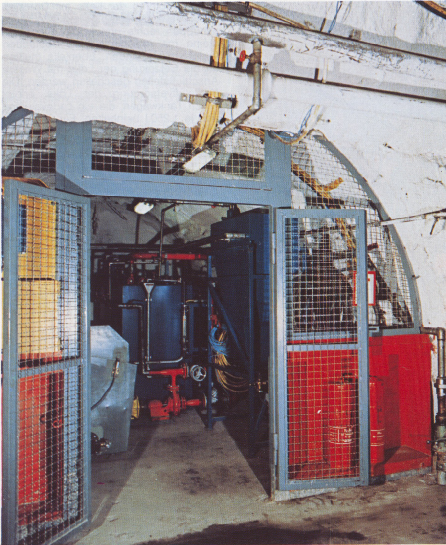
Wasseraufbereitungsanlage, Ölabscheidung und Teilereinigungsmaschine
