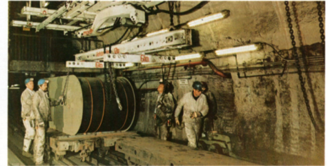
Umschlageneinrichtung im Füllort Sch. HK. 4. Sohle; Umschlag des Wickelkerns auf einem Tieflader (Abb. 4)
