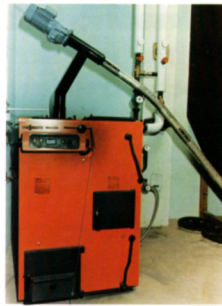
Anthrazit-Heizkessel mit automatischer Beschickung im Pfarrhaus
