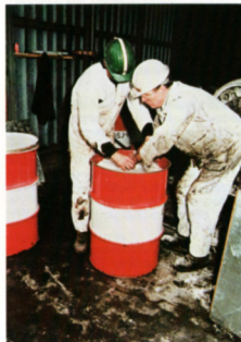
Konditionierter Sonderabfall in Fässer verpackt
