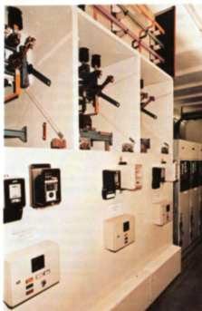
Alte und neue 5 kV-Schaltanlage Trafostation 1 — Vorderansicht (Bedienerseite)
