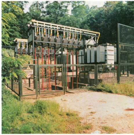
20/5 kV-Transformator 1 und 2 am Kantinenberg
