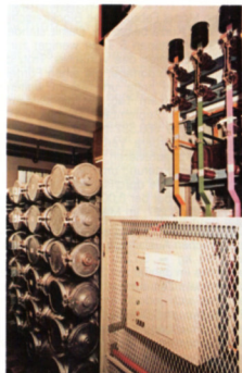
Alte und neue 5 kV-Schaltanlage Trafostation 1 — Rückansicht
