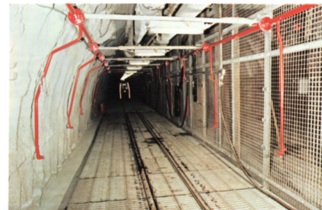
Feuerlöschscheinrichtungen dienen dem Brandschutz
