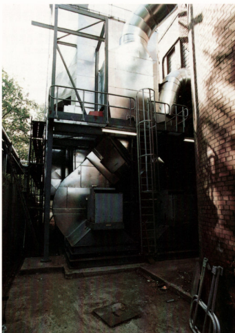
Neue Saugzanlage mit dahinterliegendem erdichtigem E-Filter
