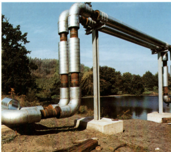
Fernwärmebrasse im Bereich der Schachtanlage 1/3
